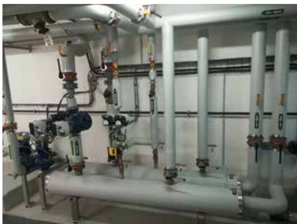
Nouvelle chaufferie - Résidence Peyronneau à Libourne
